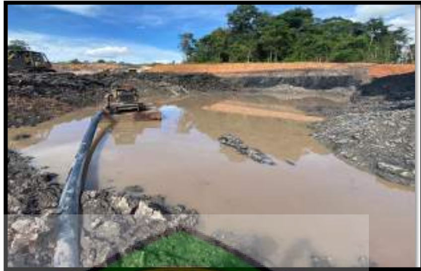
Gambar 4. 4 Kondisi sump di pit Paku
